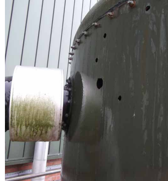
罐壁穿孔效应
